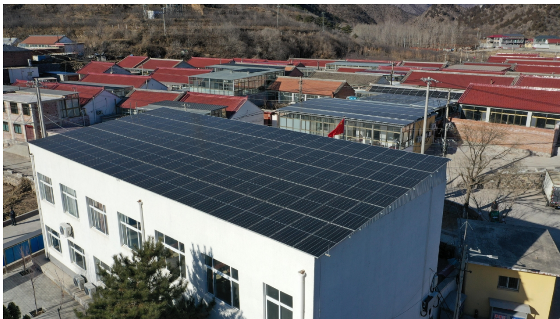
首开集团出资建设的养渔池村第一期光伏发电项目
